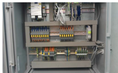
Schaltschrank für Tank
