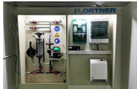
Schaltschrank für Tank
